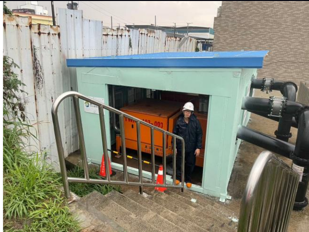
五光簡易抽水站已預佈完成。
